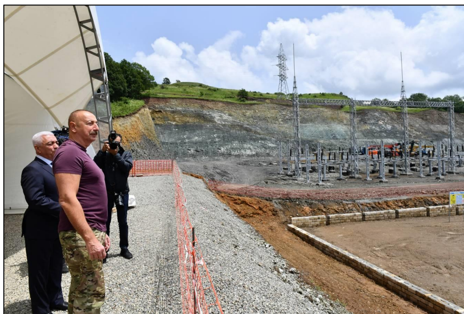
“Qorçu” elektrik yarımstansiyasında görülən işlərlə tanışlıq. 26.06.2022
